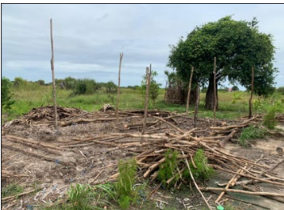
Casa de barrio destruida por las lluvias
